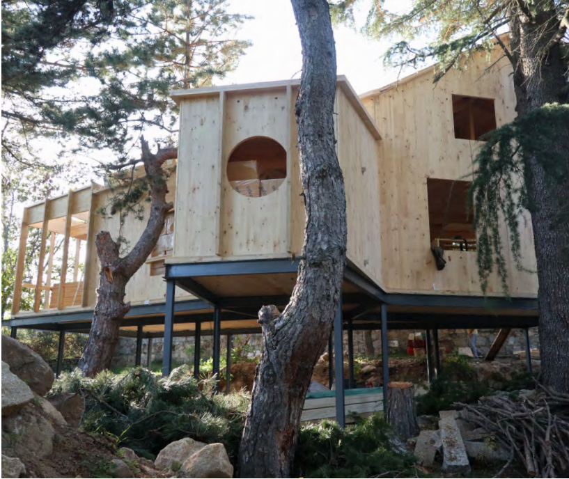
Foto. Máquina Líquen. Fase de montaje de los paneles estructurales de madera CLT (fachada este) desplegándose entre árboles, con la cabaña de las niñas en el centro y una ventana de ojo de buey.
